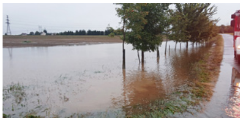
Ucpaný průchod pod silnicí vedle dálnice.
